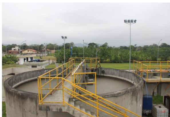
Figura 10 - ETE Espinheiros | Estação de Tratamento de Esgoto
