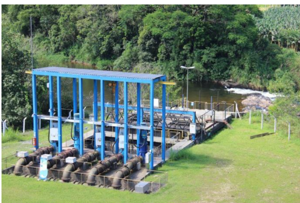
Figura 9 - ETA Cubatão | Estação de Tratamento de Água
