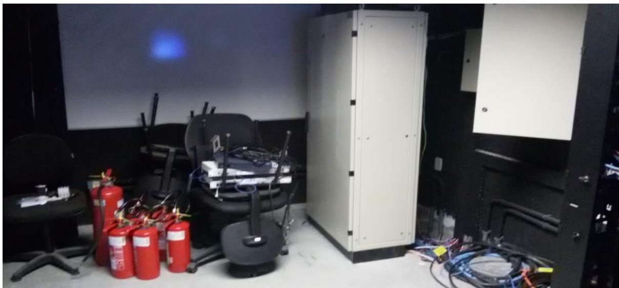
Figura 20 – Extintores Fonte: Autora, 2016.
