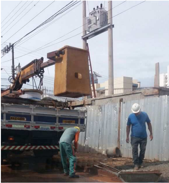
Imagem 3. Obstrução da Via Fonte: Própria Autoria
