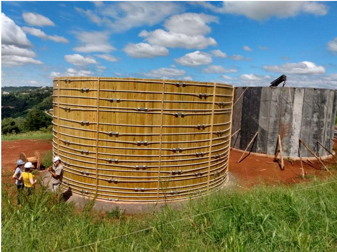
Figura 12: Reservatório do Condomínio Agroenergético em Itapiranga/SC
