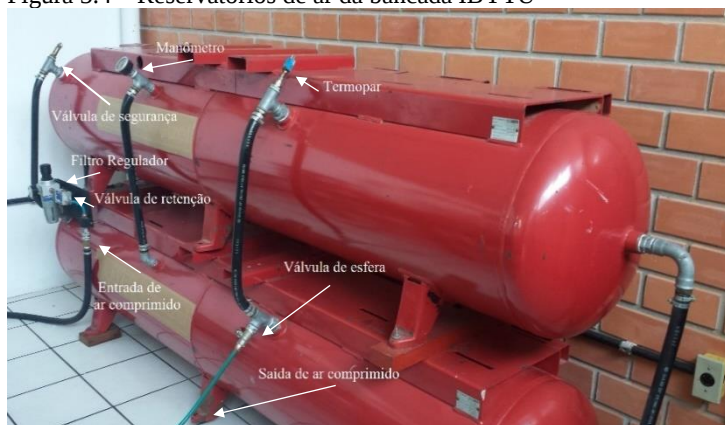
Figura 3.4 – Reservatórios de ar da bancada IBYTU
